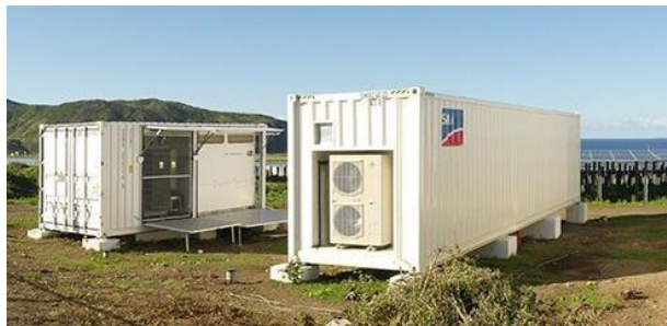
Bildquelle: SMA Solar Technology AG
